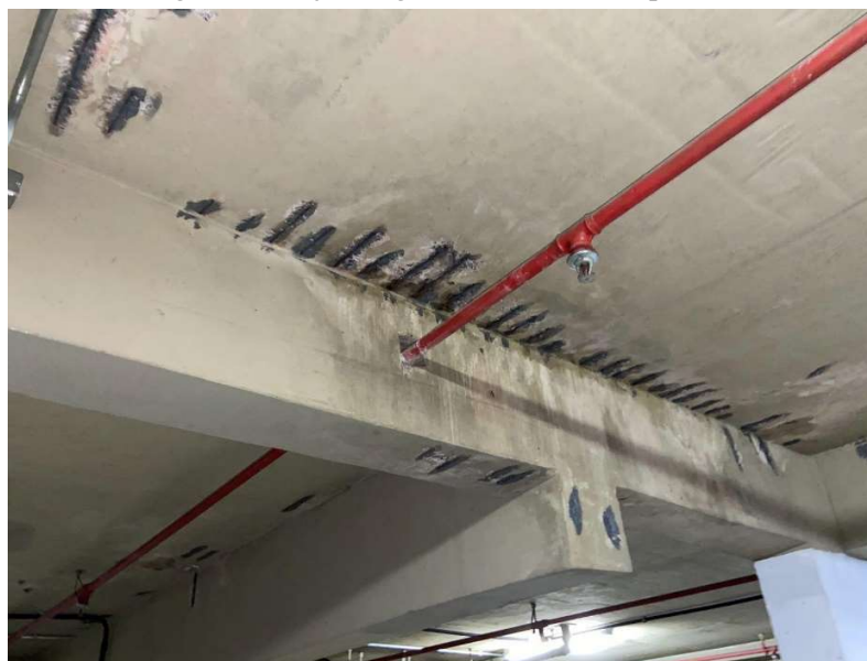
Figura 5 – Laje e viga com armadura exposta
