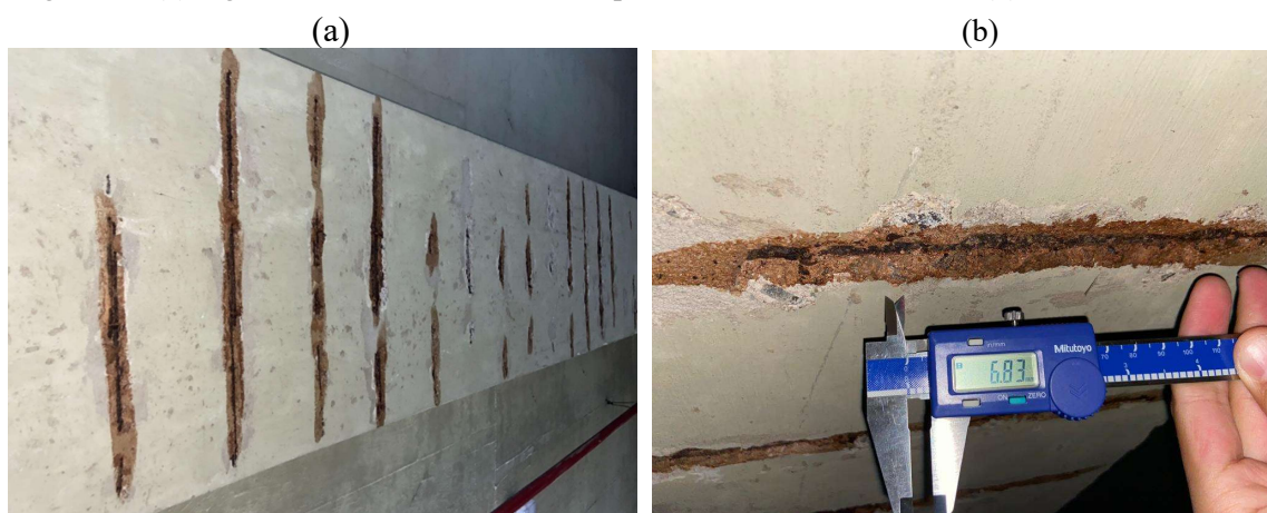
Figura 2 – (a) viga com armadura corrida e deslocamento do cobrimento e (b) cobrimento de 6,83mm
