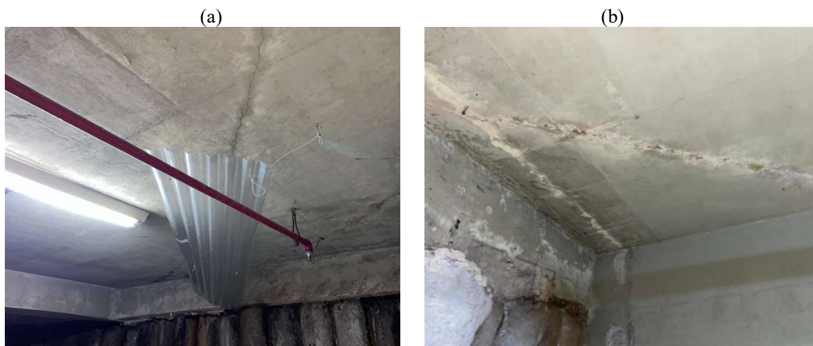
Figura 6 – (a) fissura na laje nos fundos da garagem (b) fissura na laje junto a parede de contenção nos fundos da garagem
