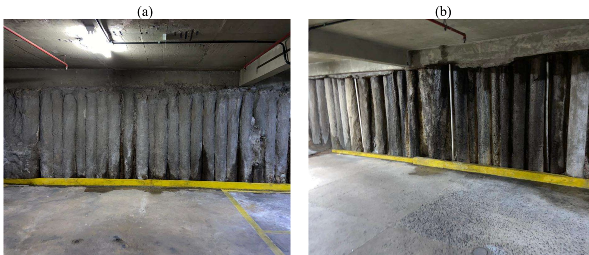
Figura 7 – Infiltração na parede de divisa aos fundos: (a) subsolo 1, e (b) subsolo 2
