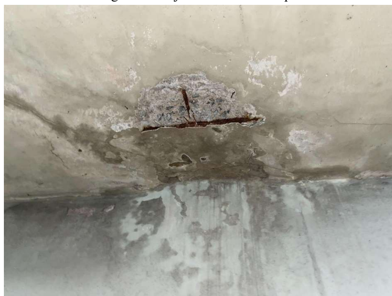
Figura 3 – Laje com armadura exposta
